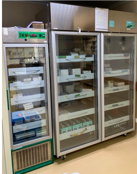
Figura 4 - Armazenamento de refrigeração
