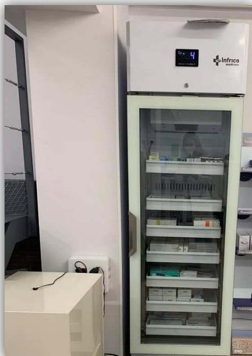
Figura 13 – Frigorífico para armazenar produtos de frio.
