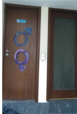
Figura 23- Instalações sanitárias à esquerda, e zona de descanso à direita.
